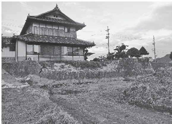
豪雨で崩壊した石垣
