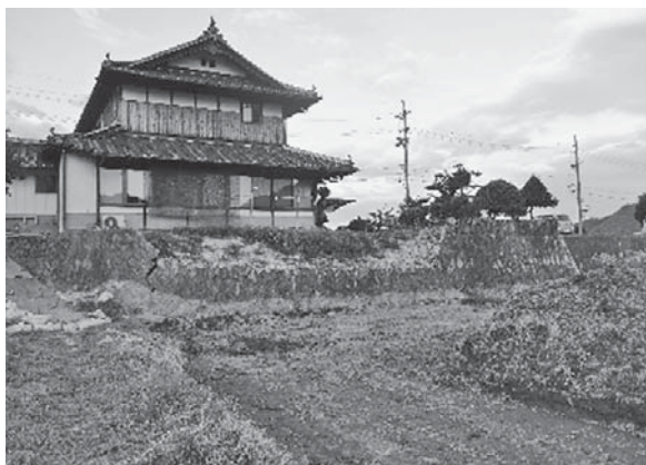
豪雨で崩壊した石垣
