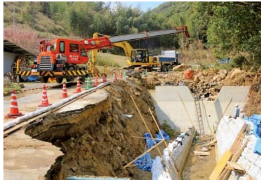
▲被災した道路や河川などの復旧工事を実施(写真は善入寺川の支川)
