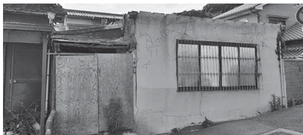
屋根が落ちた危険な空家
