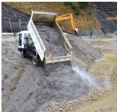
▲焼却灰などを埋め立てる最終処分場
