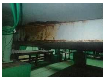
二次脱水機 ケーシング腐食
