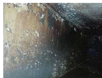
槽内壁面の防食剥離
