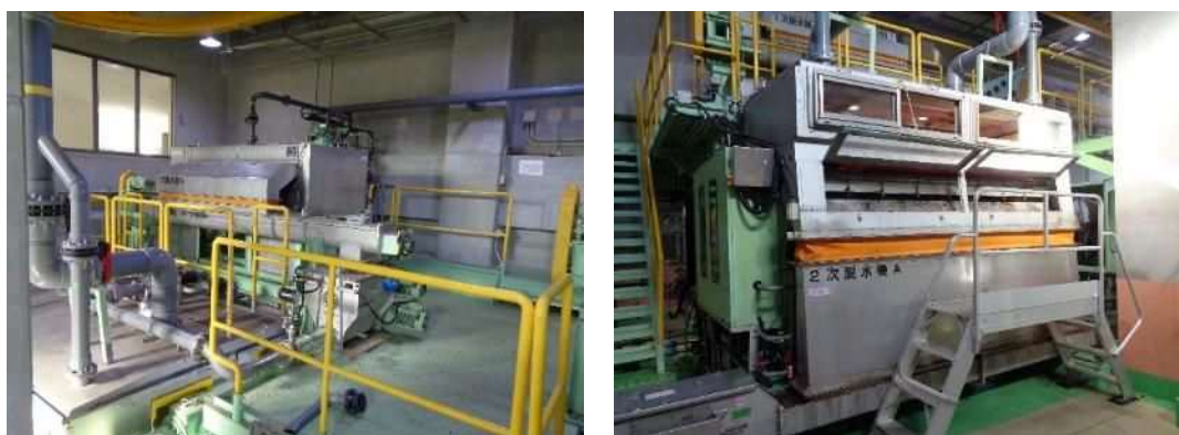
図 9 現施設の脱水機
