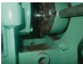
熱交換用循環ポンプ 軸まわり腐食
