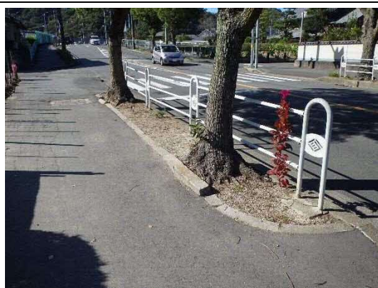
歩道上の根上がり（縁石の持ち上げ）
