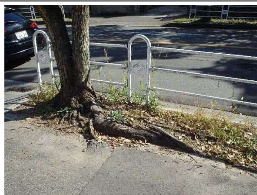
歩道上の根上がり（舗装の破損）
