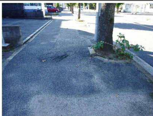
狭小な歩道（すれ違い困難） 歩道上の根上がり（舗装の破損）
