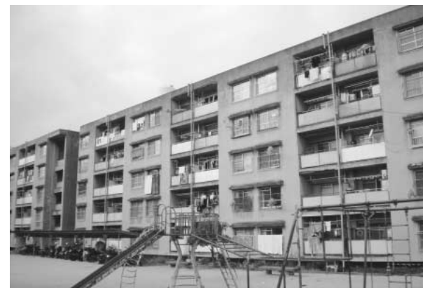
老朽化している市営住宅
