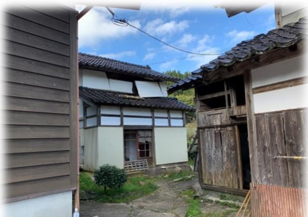
土蔵や納屋は屋根や柱が大きくズレている 解体を依頼しているとのこと
