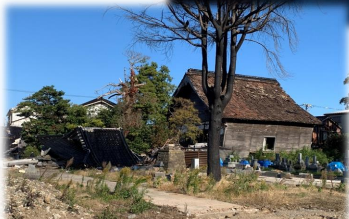
本堂の瓦がズレ落ち、鐘楼が倒壊した寺院 境内の一角が災害ゴミの集積場になっている
