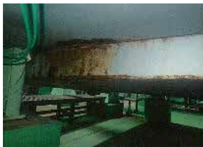
二次脱水機 ケーシング腐食
