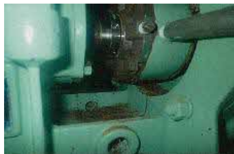
熱交換用循環ポンプ腐食
