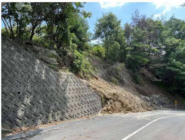
道路災害 (高坂町許山)
