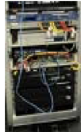
▲無停電電源装置
