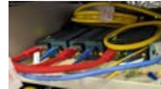
▲メディアコンバーター
