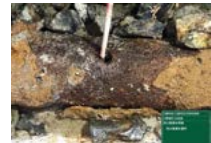
▲ 劣化した消火管の例
