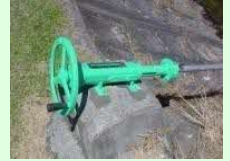
ゲート、バルブの更新
