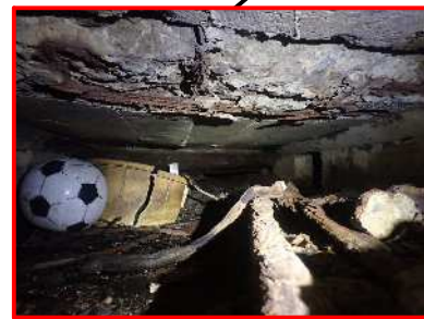
ゴミの堆積・床版下面状況(鉄筋破断有)
