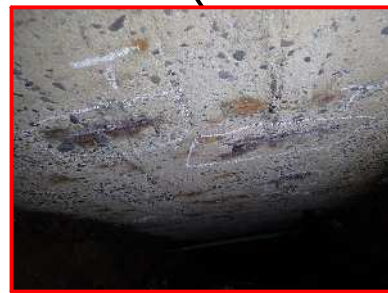
広範囲におよぶ錆跡・局部的な鉄筋露出
