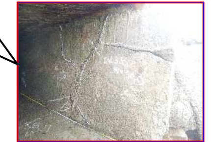
河床下部土砂吸出に伴うひびわれ
