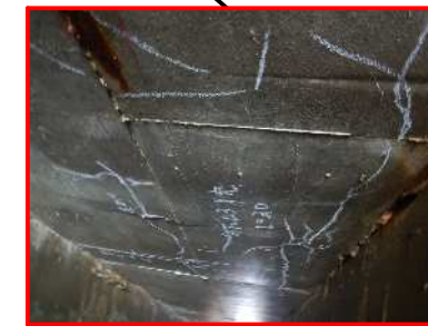
海岸部床版下面増圧部: 錆跡、うき、ひびわれ
