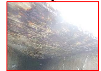
海岸部床版下面増圧部: 剥離鉄筋露出(鉄筋破断)
