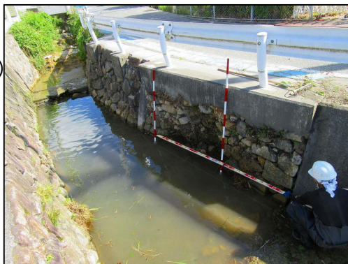
河川災害 護岸崩壊 (中之町五丁目)
