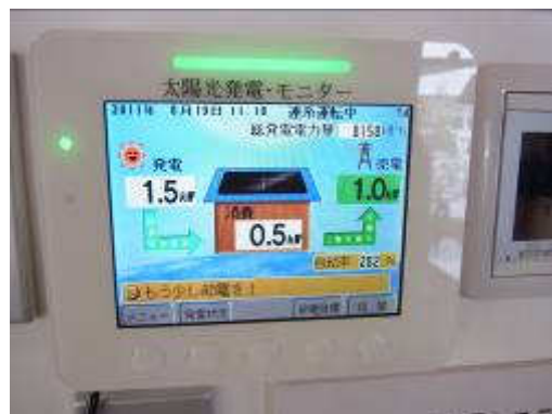
太陽光発電量と電力使用量のモニター
