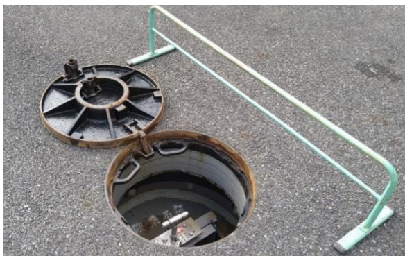
○マンホールトイレの展示
