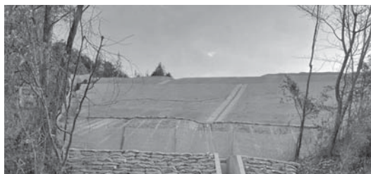
汚染危険のある浸透水を直接川に流す排水路（本郷処分場）
