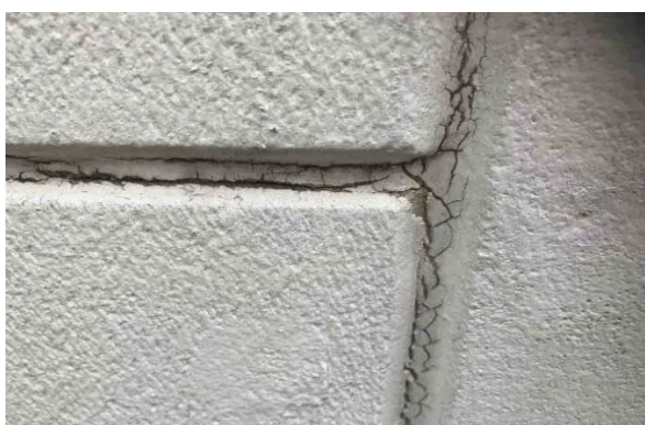
シーリング材の劣化（割れ）
