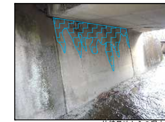
伸縮目地からの漏水跡
