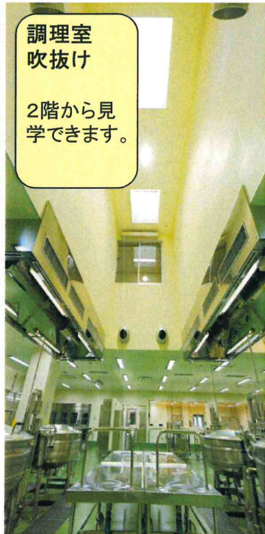
調理室 献立にあわせて回転釜・フライヤー・焼物機で炒めたり、揚げたり、焼いたり調理全般をおこないます。
