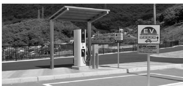
みはら神明の里の急速充電設備
