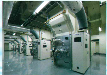
●炉室 排ガス、騒音、振動等を抑制し、周辺環境に十分配慮した設備を導入しています。
