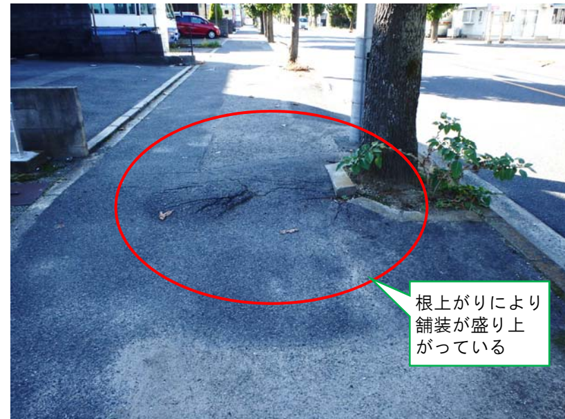
舗装や縁石の盛り上がりによる歩行者等への通行障害
