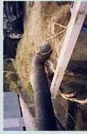
沼田東町登山 鋼管φ200耗 継手（溶接箇所）破損
