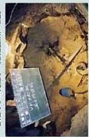
古深町 φ40耗 ビニール管 給水管破損
