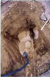
沼田西町 φ75耗 継鉄管 継手破断
