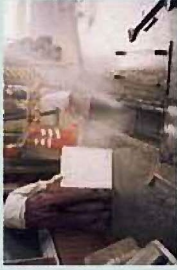
宮沖三丁目 φ13耗 鋼管 給水管破損
