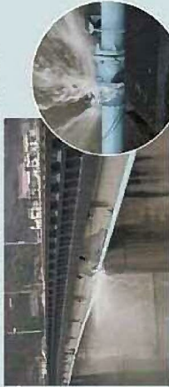
沼田東町水市場 銅管φ150耗 継手破断
