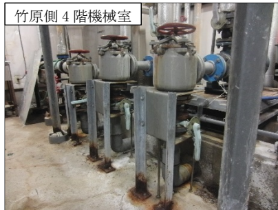
竹原側 4階機械室
