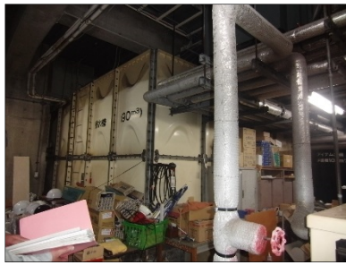
専用水道貯水槽
