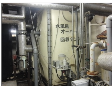
水風呂オーバーフロー回収槽
