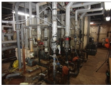
温泉系統循環設備
