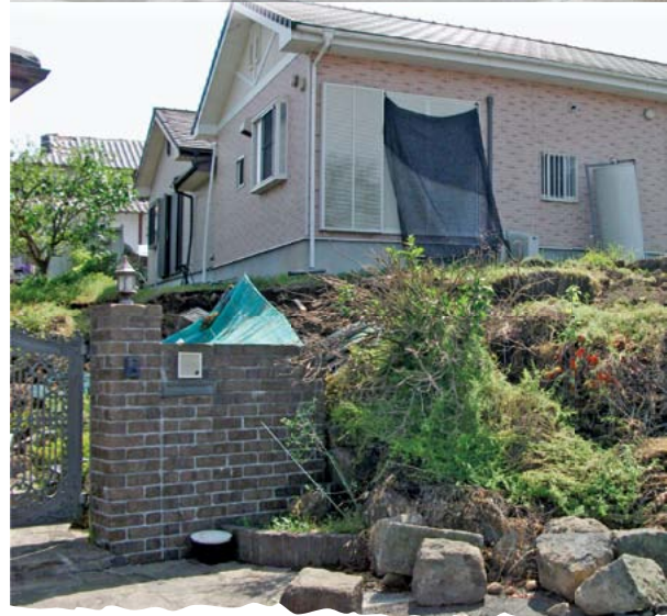
▲1階部分が押し潰された住宅や倒壊したブロック
