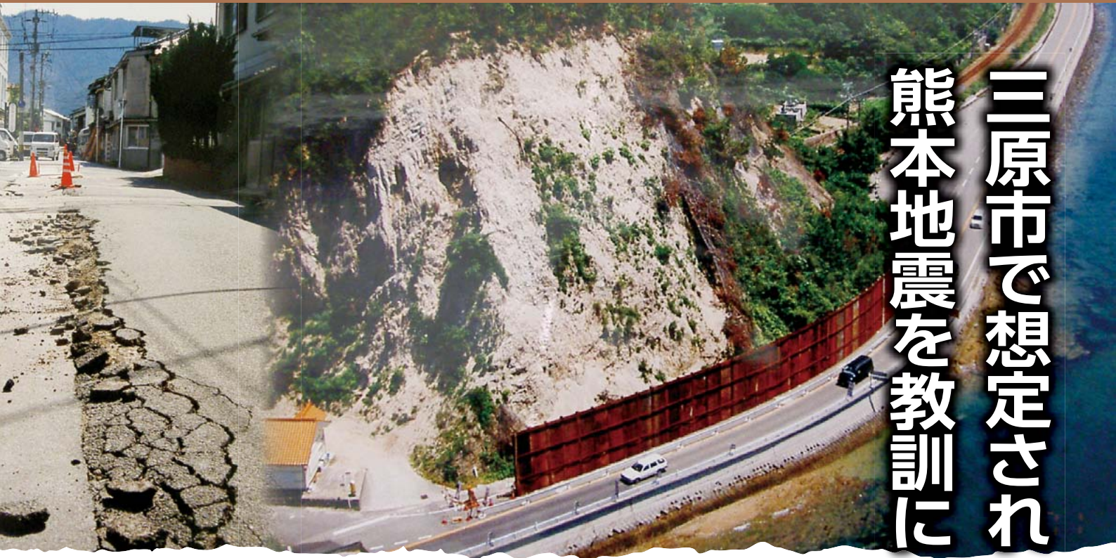
▲平成13年の芸予地震で被害を受けた三原市内。道路のひび割れ、斜面の崩落も起きました。
