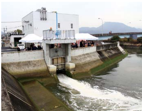
▲稼働を始めた宗郷雨水排水ポンプ場
