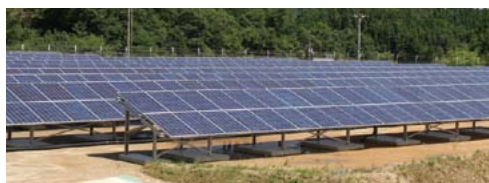
▲大和フライト産業団地で商業運転を開始したメガソーラー
