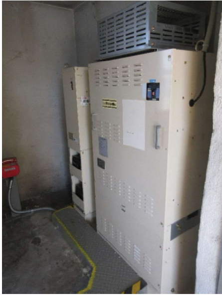
画像6 エレベーター機械室
