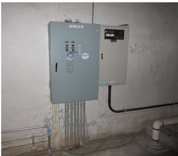
画像12 地下1階 動力制御盤
