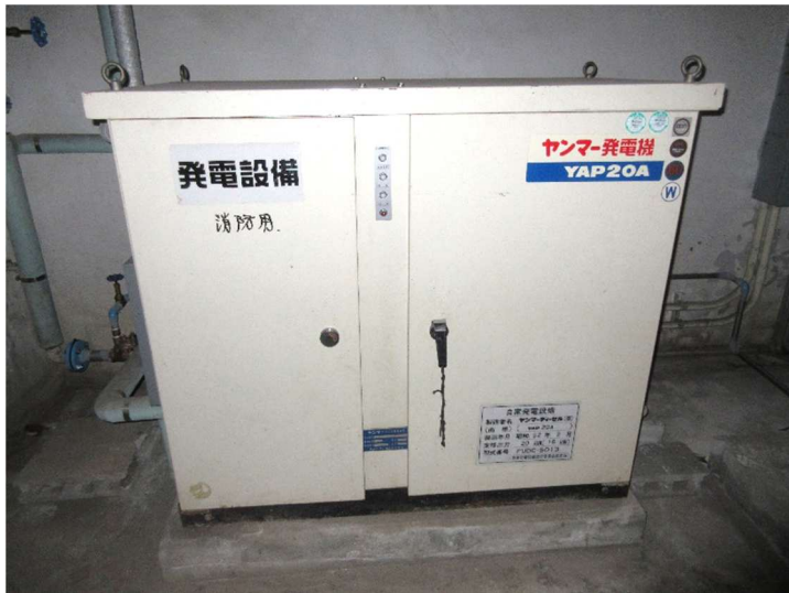
画像11 地下1階 発電機
