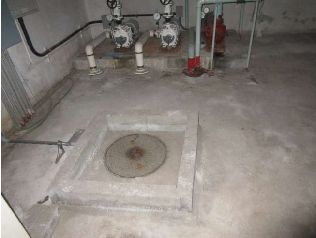
画像10 地下1階 受水槽
