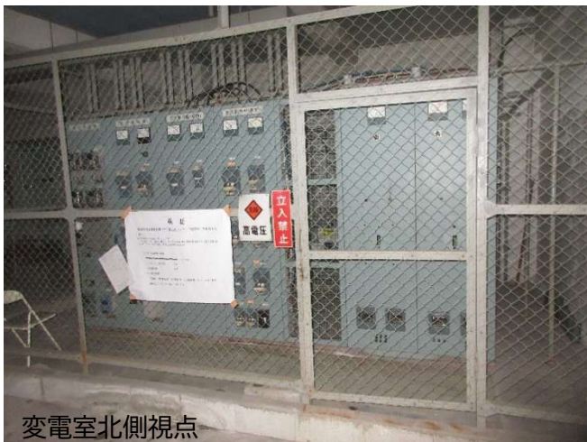
画像9 地下1階 変電室
