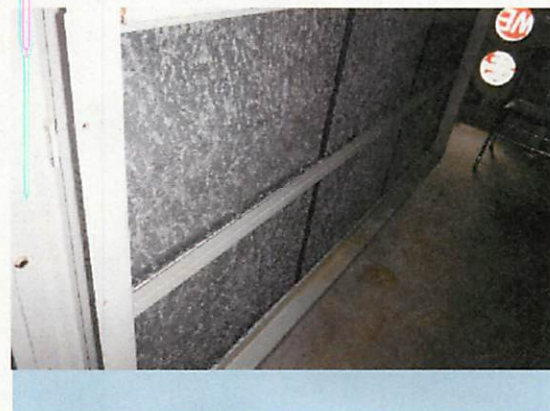
状況・コメント：目詰まり
