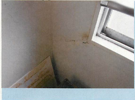
状況・コメント：漏水跡あり
