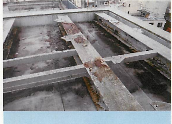
状況・コメント：防水下に水たまり, 鉄骨架台にひどい錆あり
