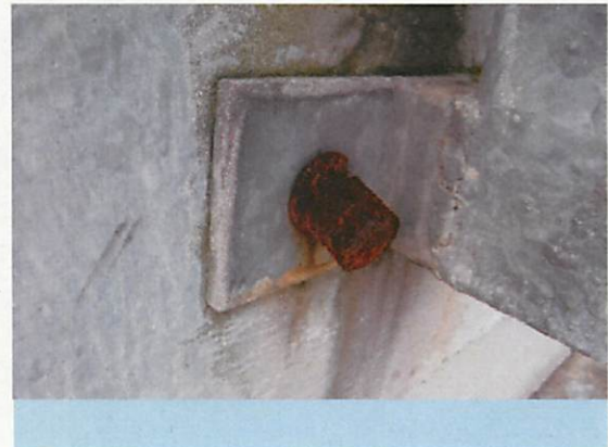
状況・コメント：固定ボルト劣化(拡大)
