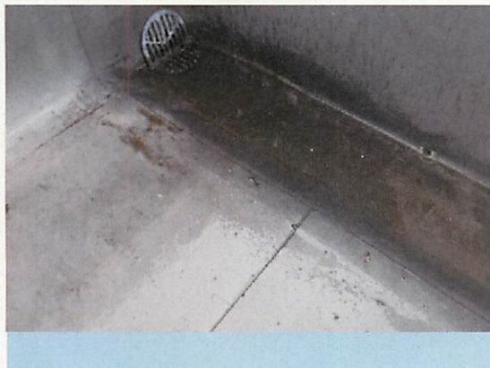
状況・コメント：排水溝水たまり
