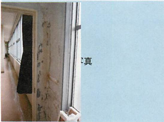
状況・コメント：漏水の痕跡あり
