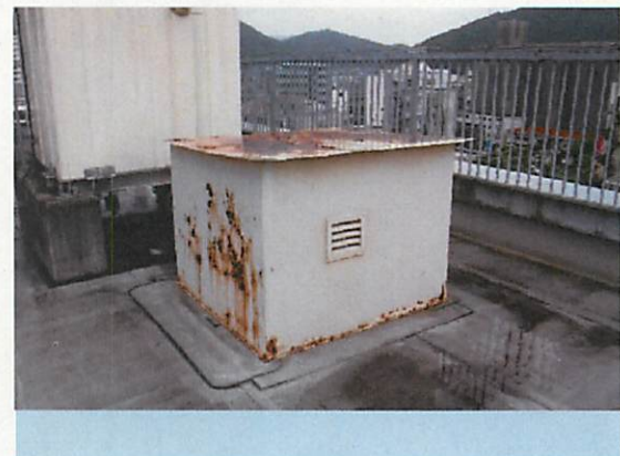
状況・コメント：不明老朽設置物腐食あり
