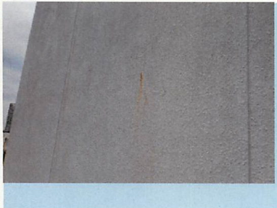
状況・コメント：錆あと(拡大)
