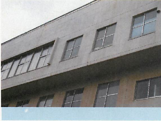
状況・コメント：ひび割れ
