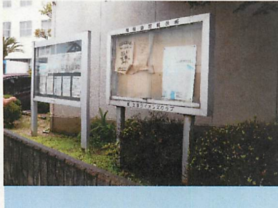
状況・コメント: 柱脚腐食
