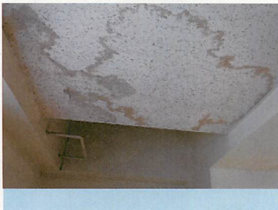
状況・コメント：漏水跡あり
