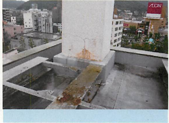
状況・コメント：ひび割れ, 錆あと
