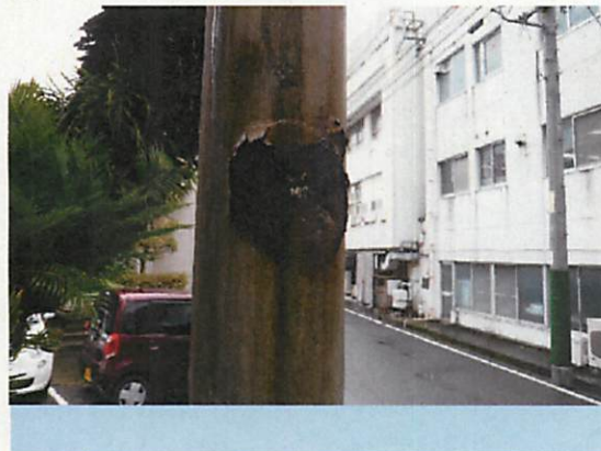
状況・コメント: 錆あり
