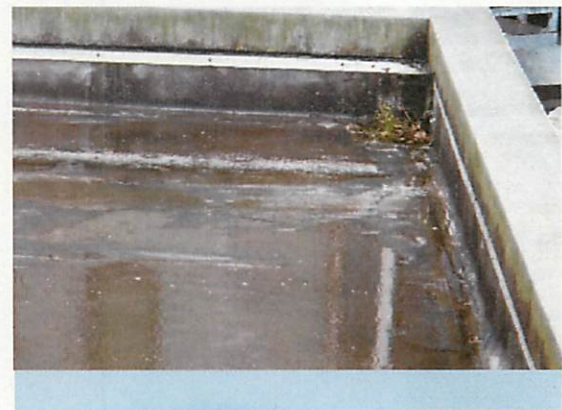
状況・コメント：排水口つまり, 植生あり
