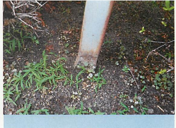
状況・コメント: 柱脚腐食(拡大)
