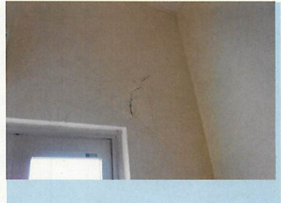
状況・コメント：漏水の痕跡あり
