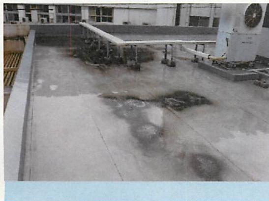
状況・コメント：排水口閉塞, 水たまり
