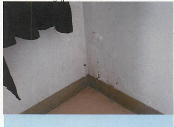
状況・コメント：雨漏りの痕跡あり
