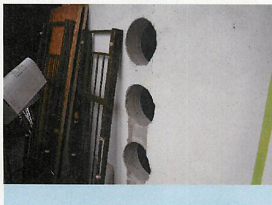
状況・コメント：コア抜きされたまま
