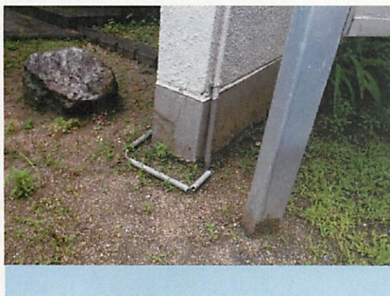
状況・コメント：脱落
