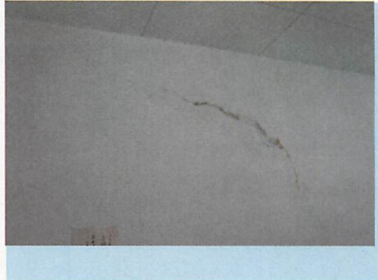
状況・コメント：漏水跡あり
