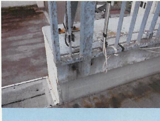
状況・コメント：固定ボルト劣化
