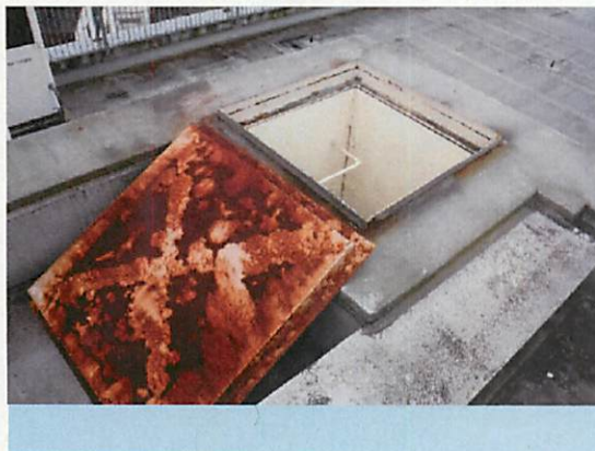
状況・コメント：破損及び未施錠
