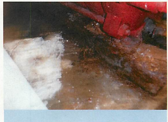
状況・コメント: 腐食あり
