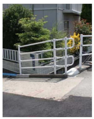
▲「市民の声」を受け、設置した転落防止柵
